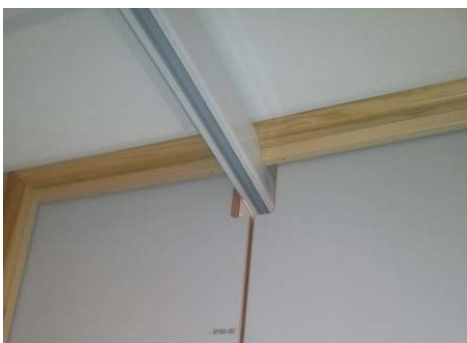
Skinne-gjennomføring og doble skyvedører
