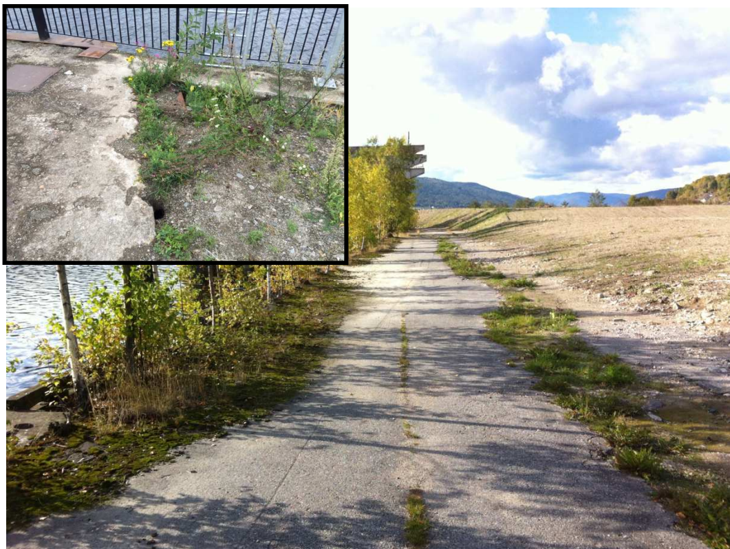
Figur 2 Før: Betongdekket hadde flere hull og skader
